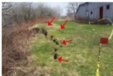
Se méfier des fissures au sol
