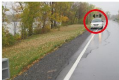
Ne pas circuler ou stationner à l'intérieur de la zone fissurée
